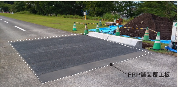
走行試験時設置状況
