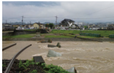
花月川橋りょう被災状況
