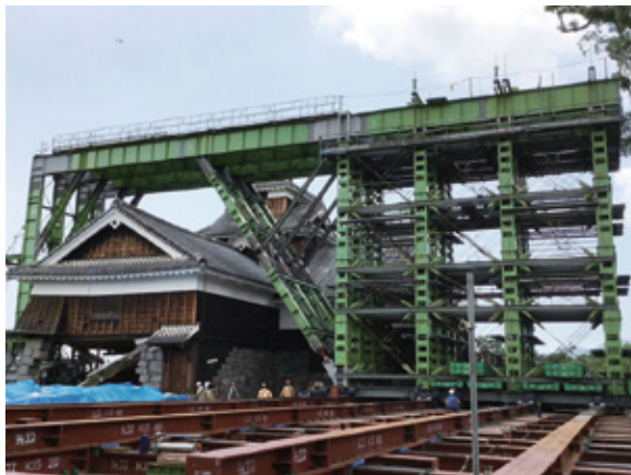
倒壊防止設備
